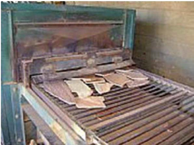
Figura 15 – Forno de tratamento térmico
